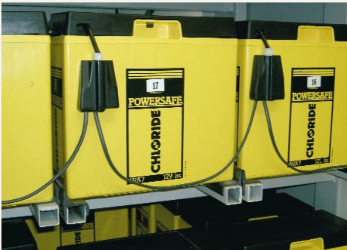
Les capteurs sont connectés en série sur un bus numérique 2 fils S-Bus relié en amont à un superviseur.
