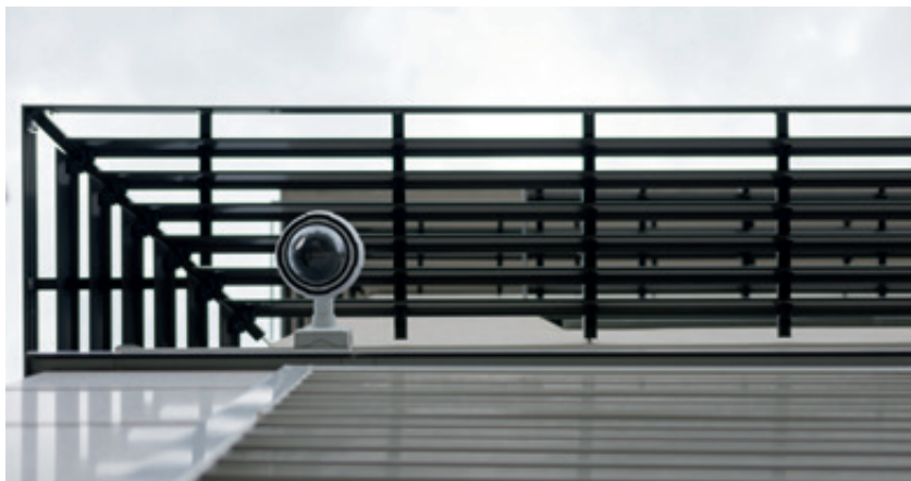
► Vidéosurveillance d'un bâtiment tertiaire sécurisé.
