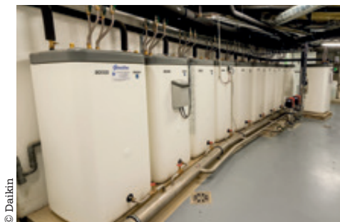
► Accumulateur de chaleur solaire pour accueillir 3 000 curistes/an à l'hôtel Avène, dans l'Hérault.
